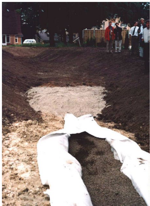
Aanleg van een van de eerste wadi's in Nederland in Ruwenbos (Enschede) met een drainagekoffer bestaande uit aggregaat (donkergekleurd) en geotextiel (wit).
