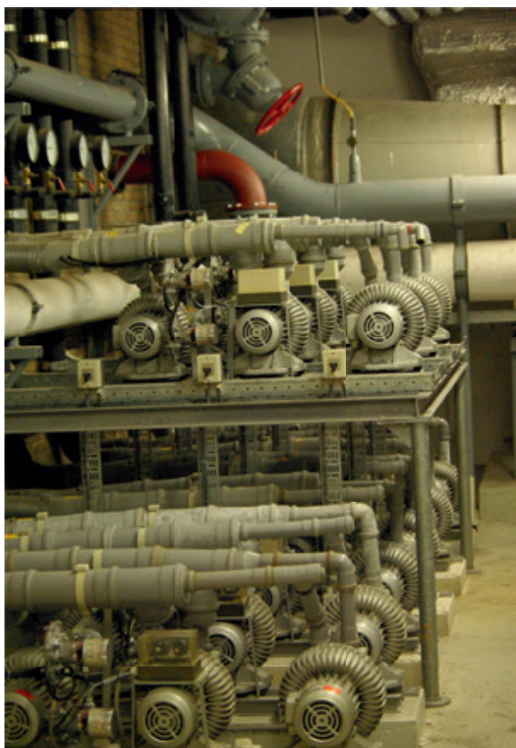
De installaties in het voormalig ACTA gebouw (Amsterdam) konden deels worden hergebruikt. Hierdoor geldt het rechtens verkregen niveau. (foto's: ACTA en Hembrugterrein: S. Gelinck)
