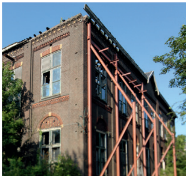
Hembrugterrein; de monumentale waarde van het bouwwerk mag niet worden aangetast door transformatie.
