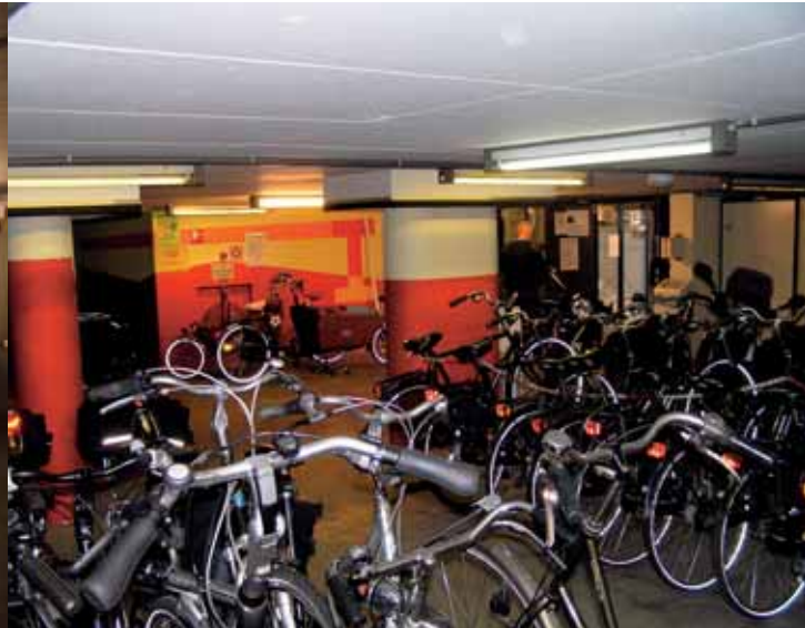
Fietsenkelder met retro-fit ledlampen in de armaturen van conventionele tl-verlichting.
