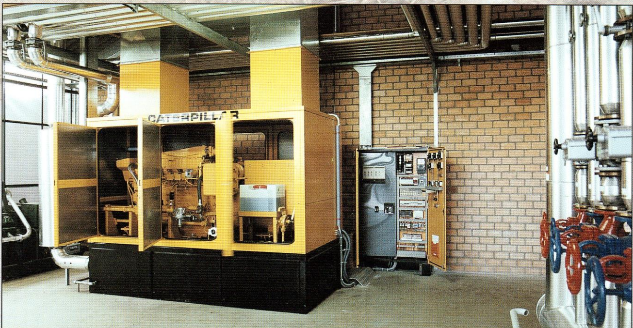
■ Geleverd door de WKK-eenheid ■ Geleverd door uw eigen installatie
